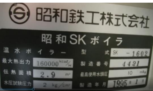
銘板の能力を見て
